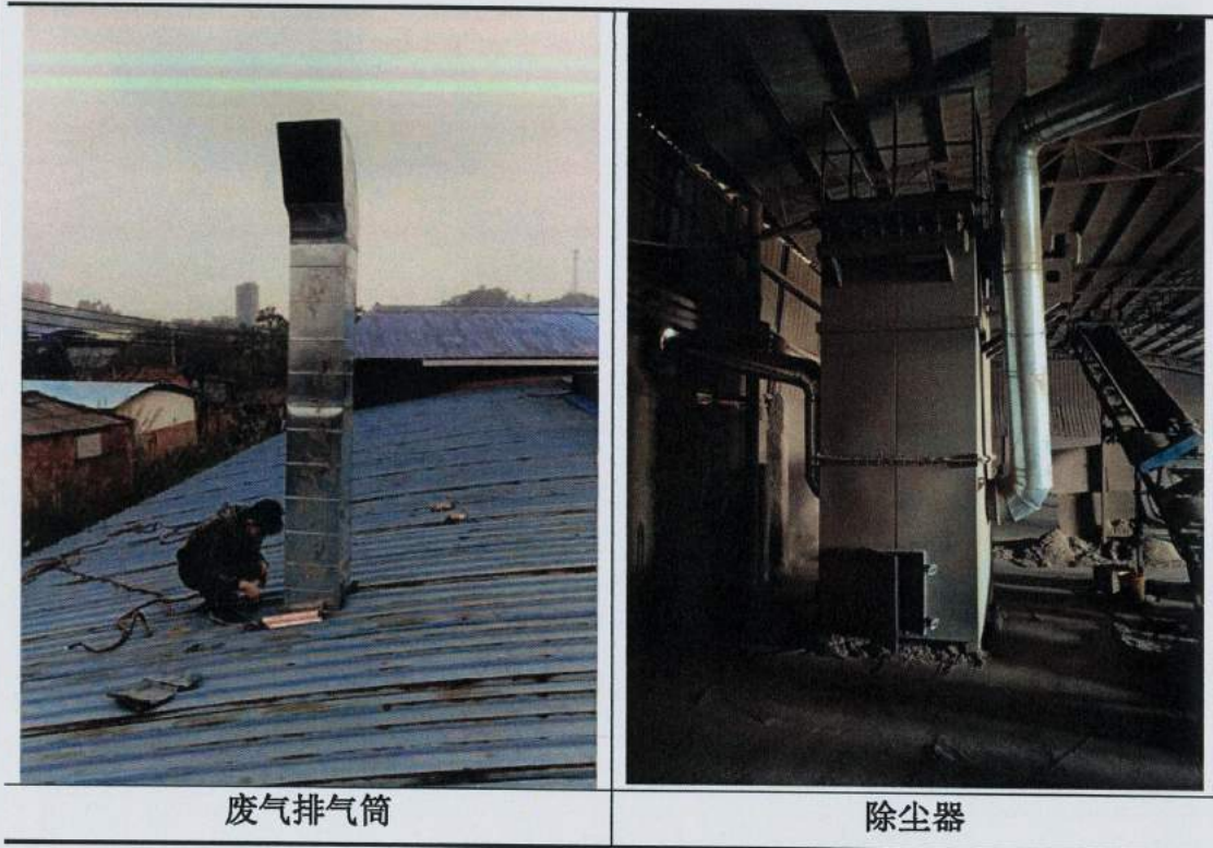
图 3-3 废气治理措施及排污口标识照片
