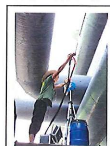
2#发泡工序废气处理前
