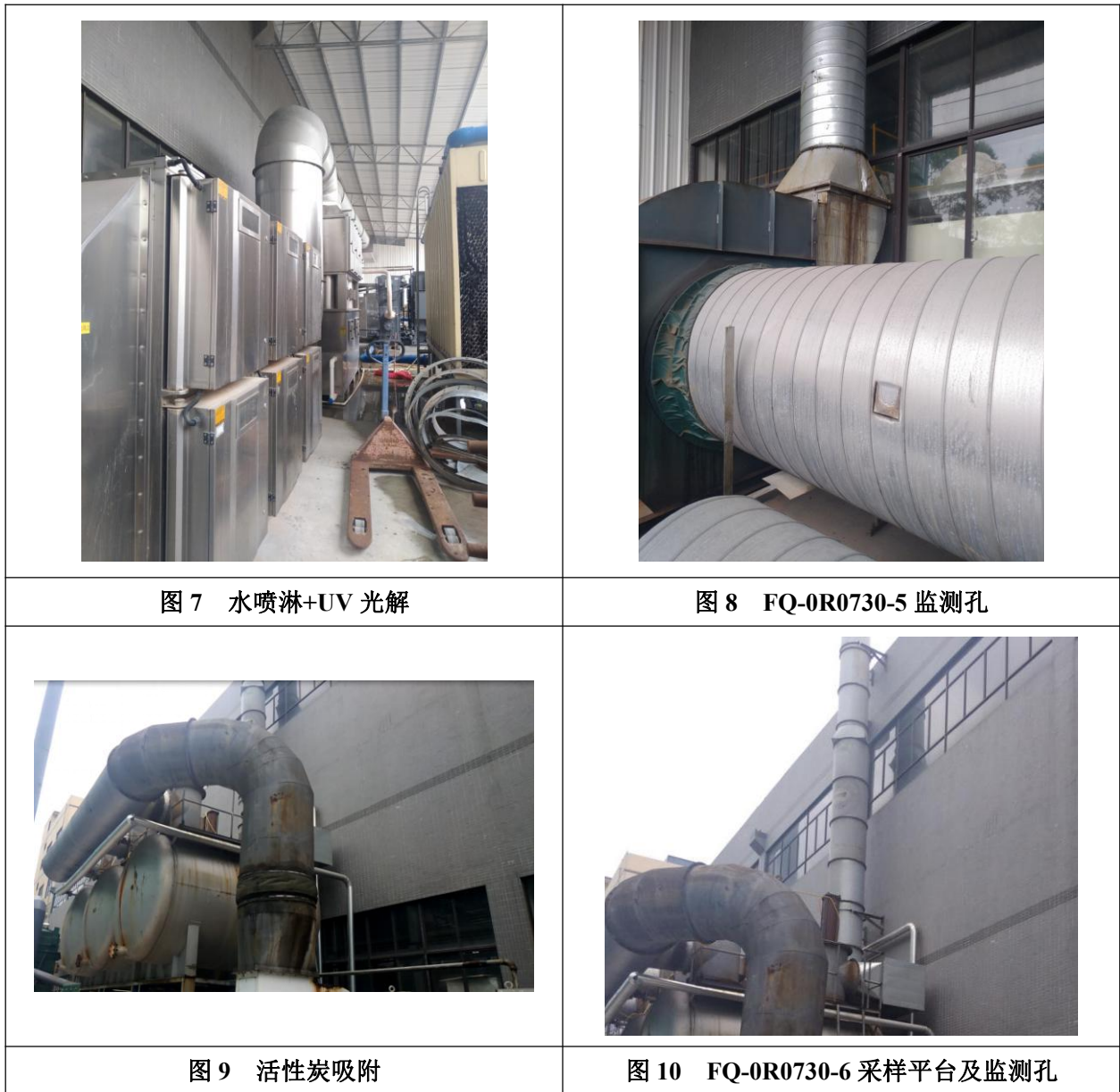
图 4-1 废气治理设施
