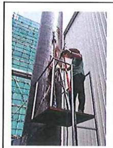
生物质锅炉处理后
