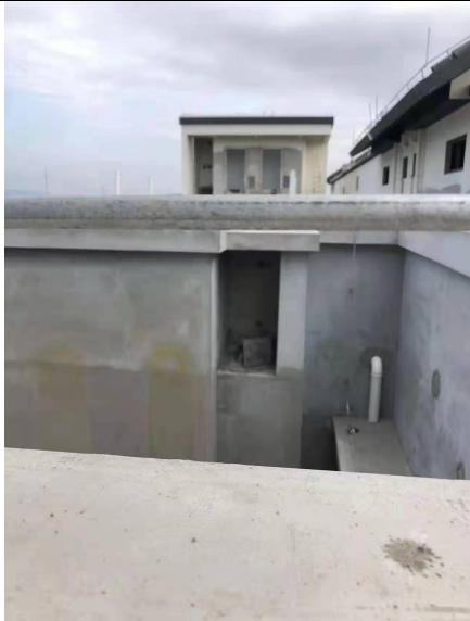
图 1 住宅楼楼顶油烟排放口
