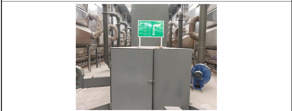
图 10 P6-1 烘干系统燃烧烟气排放口（DA006）及其标识牌
