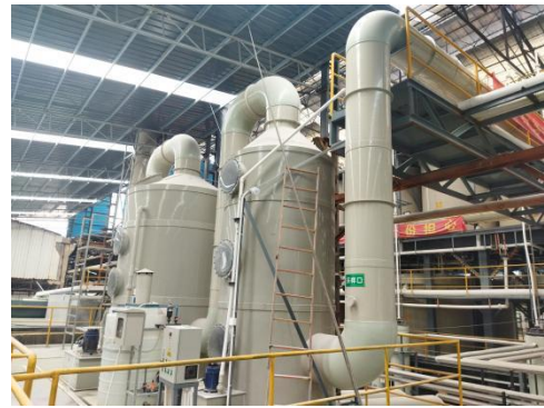
图 4 三级碱液喷淋系统
