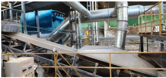
图 3 集气罩+布袋除尘器
