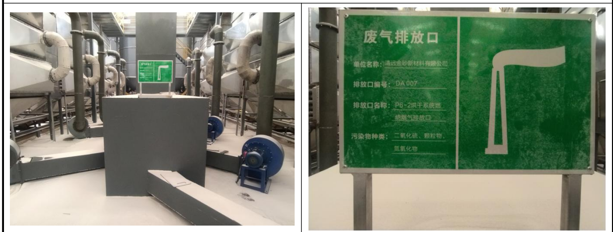
图 11 P6-2 烘干系统燃烧烟气排放口（DA007）及其标识牌
