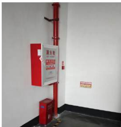
生产车间消防器材
