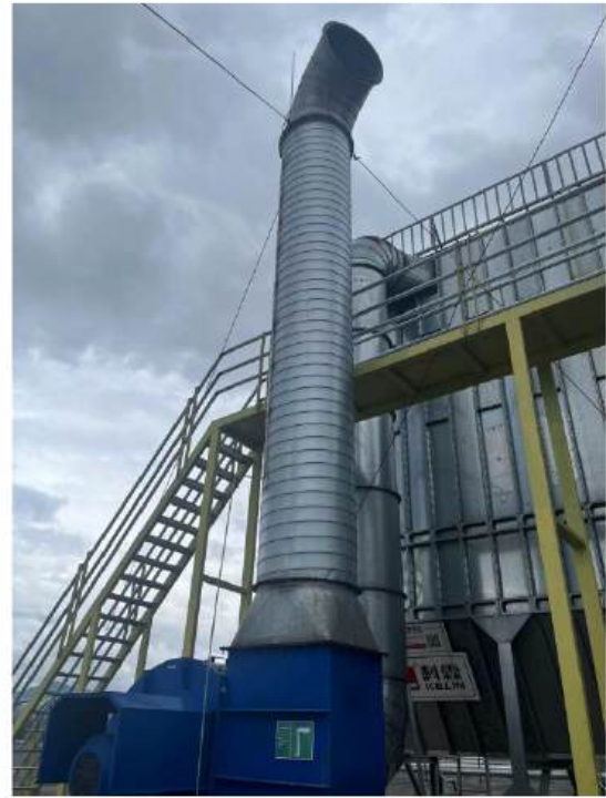
中央集尘后采样口（DA010~DA012）
