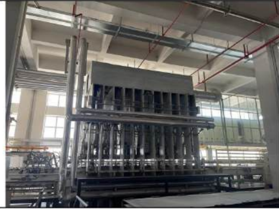
浸渍线、压板线有机废气收集
