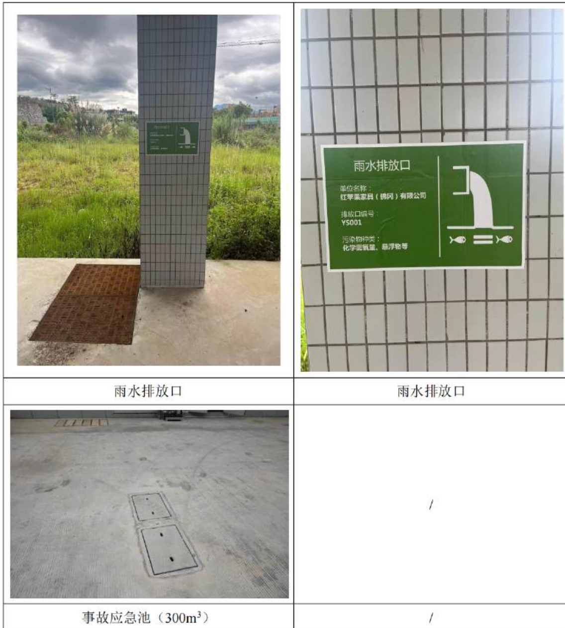
图 3.5-1 厂区废水处理设施图
