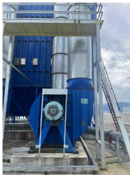
中央集尘后采样口（DA007~DA009）
