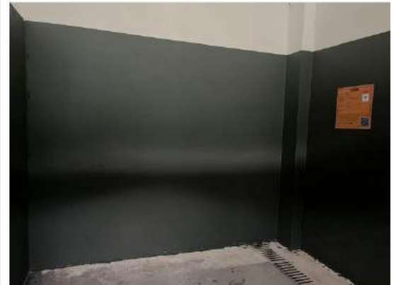
危废仓（内部），地面涂覆灰色地坪漆
