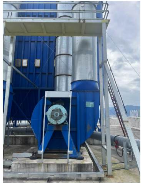
中央集尘后采样口 (DA007-DA009)
