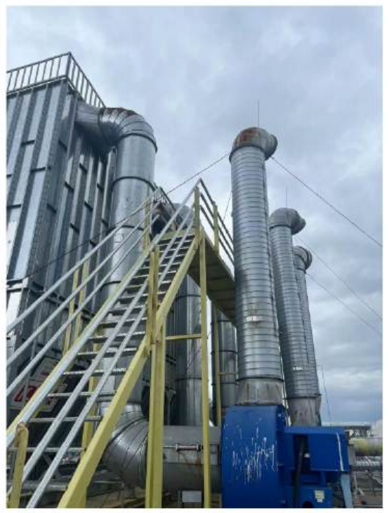
中央集尘后采样口（DA001~DA003）
