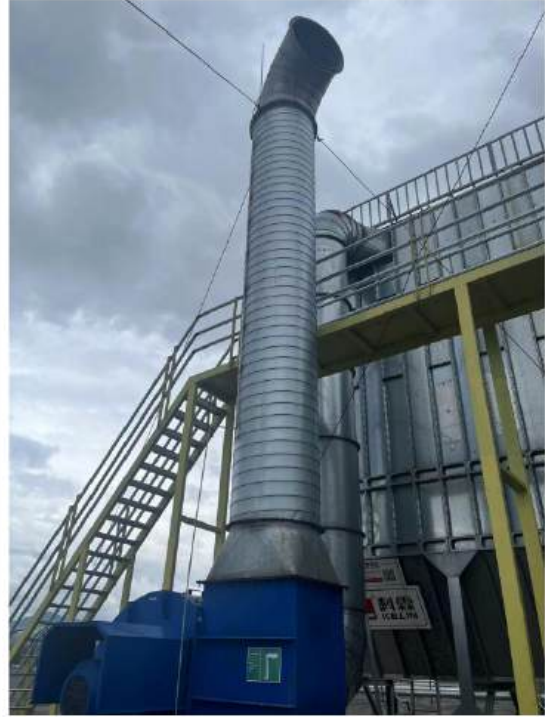
中央集尘后采样口 (DA004-DA006)
