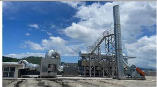
床垫生产有机废气高效旋流柜+干式过滤+活性炭吸附浓缩+催化燃烧（CO）
