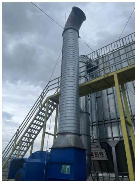
中央集尘后采样口（DA010~DA012）
